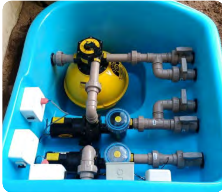
Motor de Piscina na Caixa de máquinas
